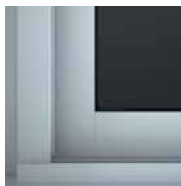
Detalle ext: parte inferior drenaje oculto
